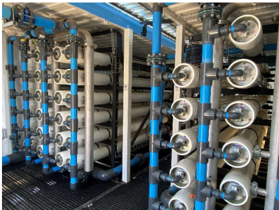
Nanofiltration zur Entsalzung
